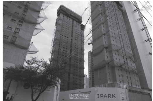
〈전면철거가 진행 중인 광주 화정 아이파크 공사 현장〉
